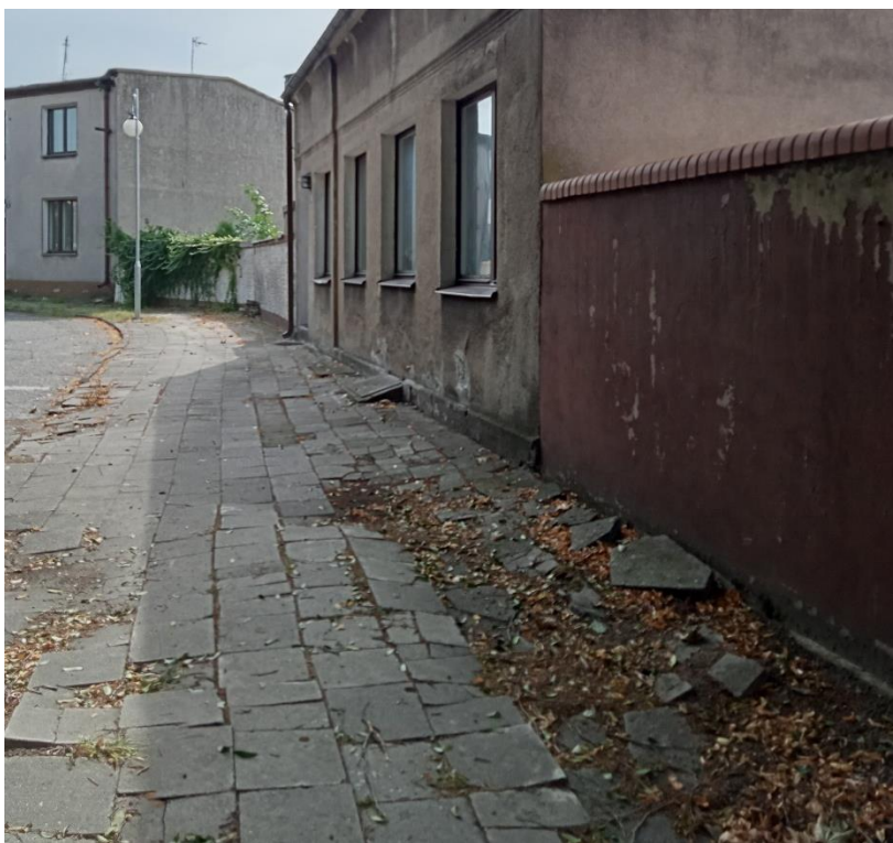
Rycina 23 Ciągi piesze w złym stanie technicznym na obszarze rewitalizacji. Źródło: wizja lokalna 22.08.2024.
