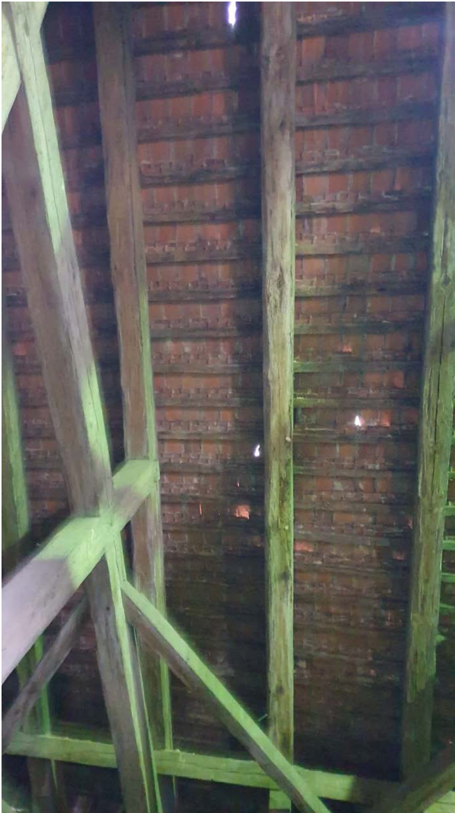
POŁĄC DACHU - NIESZCZELNOŚCI POKRYCIA DACHOWEGO
