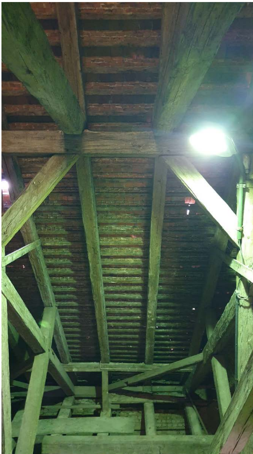
POŁĄC DACHU - NIESZCZELNOŚCI POKRYCIA DACHOWEGO
